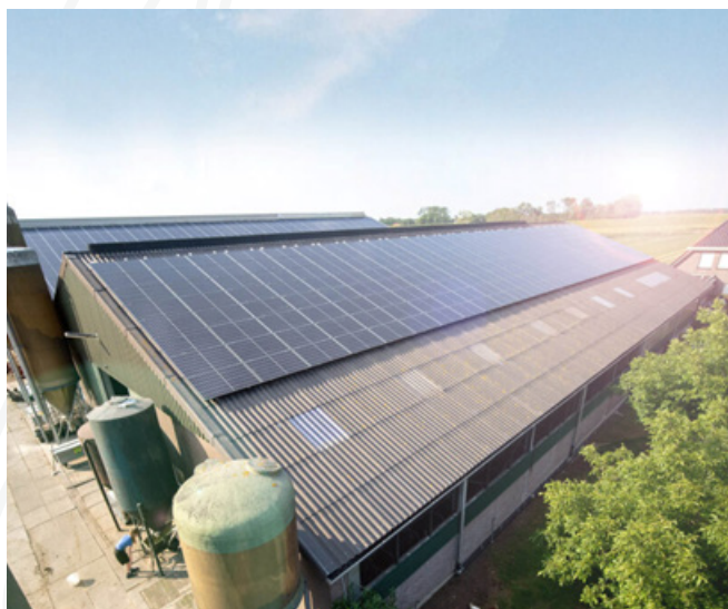
Figuur 5: Zonnepanelen op dak van veehouderij (Cor van der Waal)
